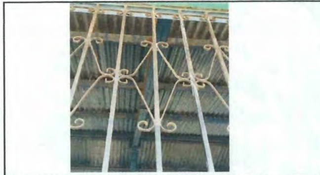
Foto 4: Se observa el balcon que se requiere mantenimiento.
