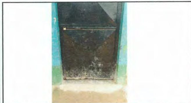
Foto 3: Se observa el deterioro de la puerta portante.
