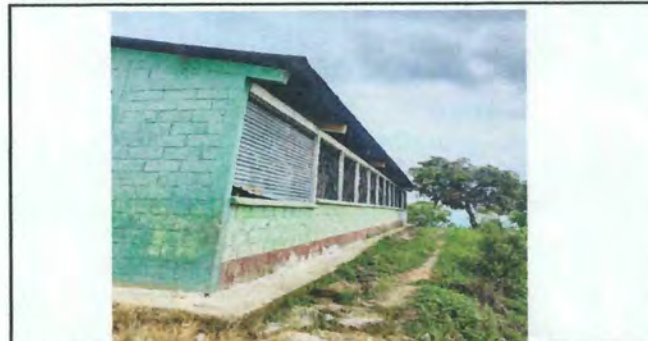
Foto 6: Se observa el desprendimiento de la pintura en las aulas.
